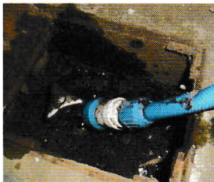
▲ 水の溜まった埋設型散水栓
